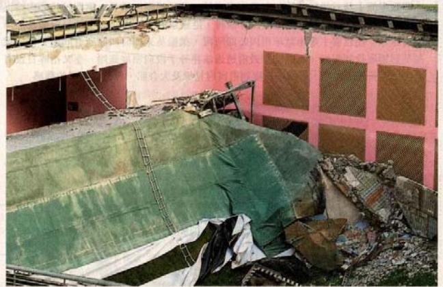
本報記者昨午所見，早前塌頂的城市大學胡法光運動中心仍被封鎖，工程人員綁上安全繩後，會沿圖中的繩梯往下走檢查。 (陳淑安攝)
