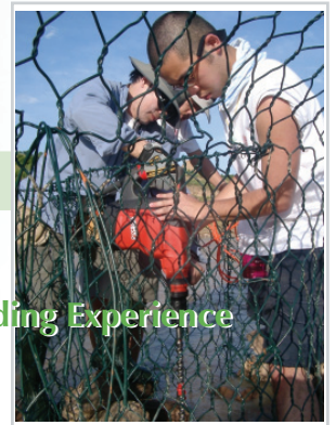
建橋現場唯一的機械工具 The only mechanical tool used on the site
